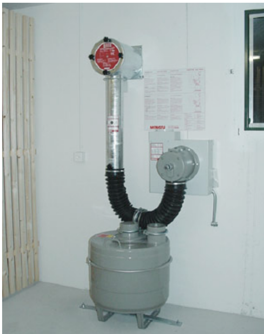
Schutzraum Belüftungsanlage Typ VA 150
